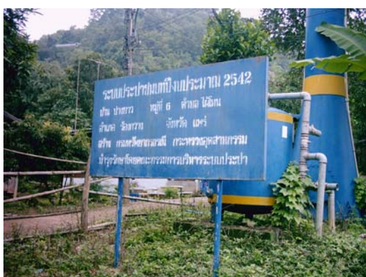
รูปที่ 5 น้ำประปาหมู่บ้านปางยาว เป็นระบบประปาที่จัดทำโดยกรมทรัพยากรธรณี ปี 2542 (PS-4)
