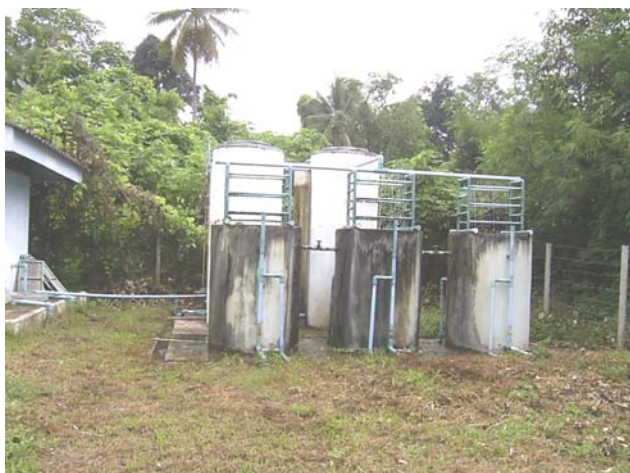
รูปที่ 6 ระบบประปาหมู่บ้าน บ้านเวียง
